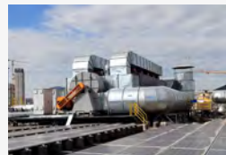
废气治理系统升级改造
