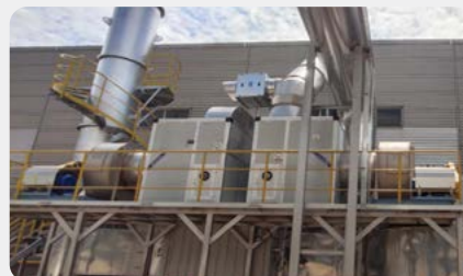
VOCs氧化余热回收装置
